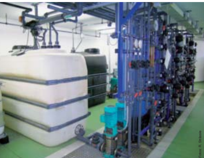
Die vollautomatische Ionenaustauscher-Kreislaufanlage.
